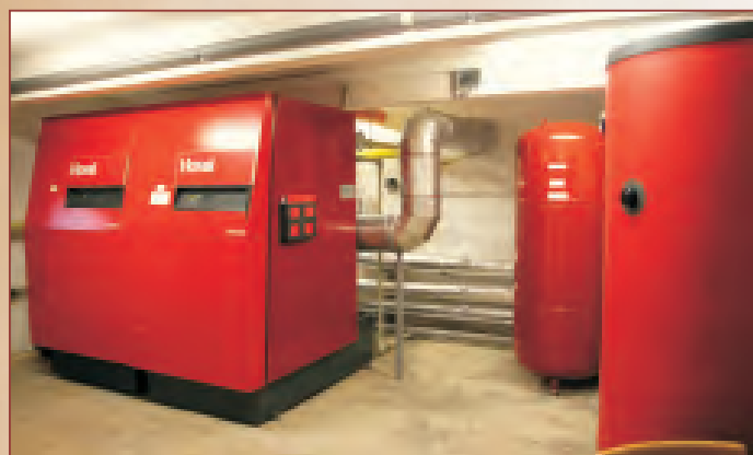
Plynová kotelna na ZŠ (r. 2011)
